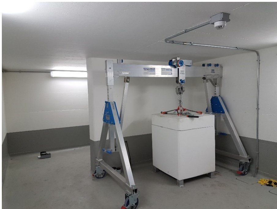
Figura 4 – Pozzetto schermante posizionato nel locale di stoccaggio ritrovamenti
