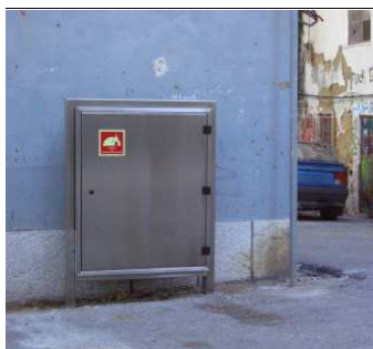
Figura 10: Armário de 1.ª Intervenção.
