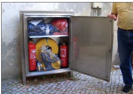
Figura 11: Armário de 1.ª Intervenção. Equipamentos de 1.ª Intervenção e de Protecção Individual.
