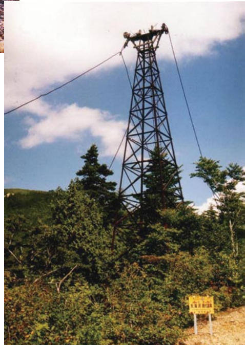
【写真6】 索道の支柱（鉄塔）
