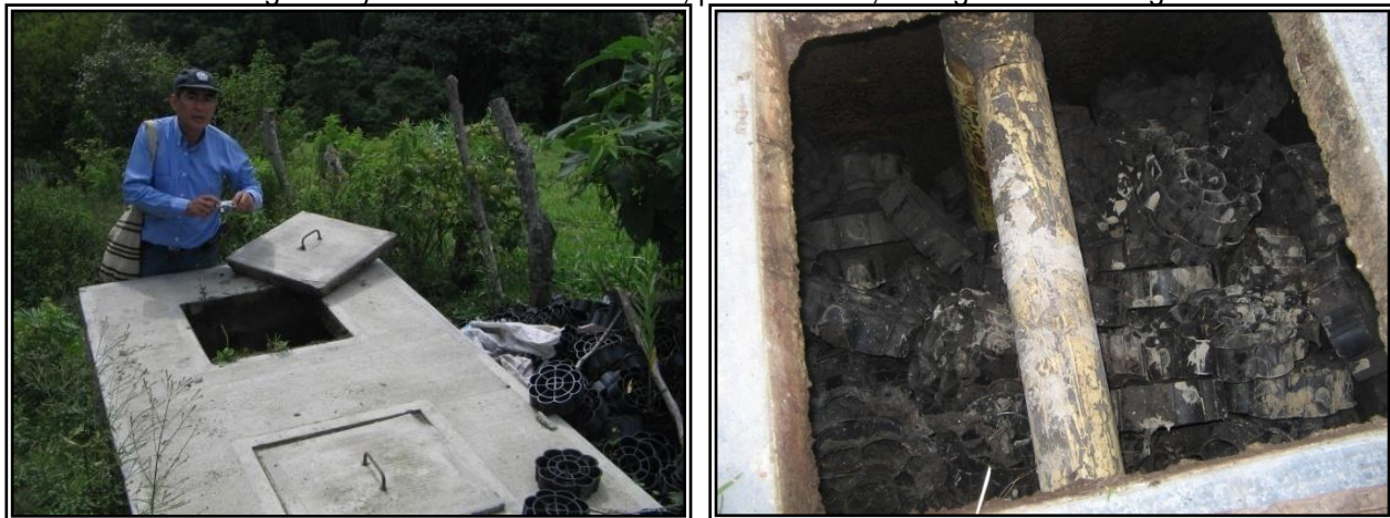
Fotografía 32. Pozo séptico ubicado en el predio, fuera de funcionamiento por sedimentación en trampa de grasas y tuberías de conducción, predio Unicorn, corregimiento Córcega
