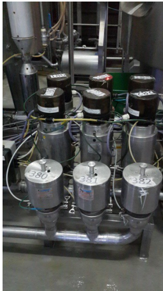
Figura 9: Válvulas automáticas para regular la circulación de leche
