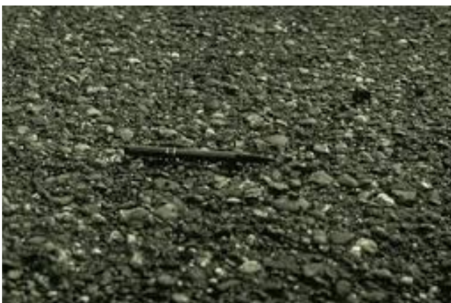
Imagen N° 18 - Pérdida de agregado (PA, Unidad de medida: m 2 )
