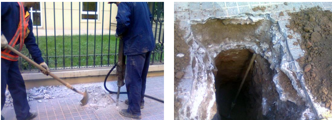
Figura 3.36: Rotura de contrapiso de H° - Servicio a gran profundidad
