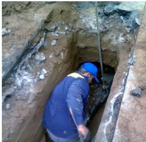
Figura 3.28: Rotura de pared de BRp en cruce sobre calle Paraná.
