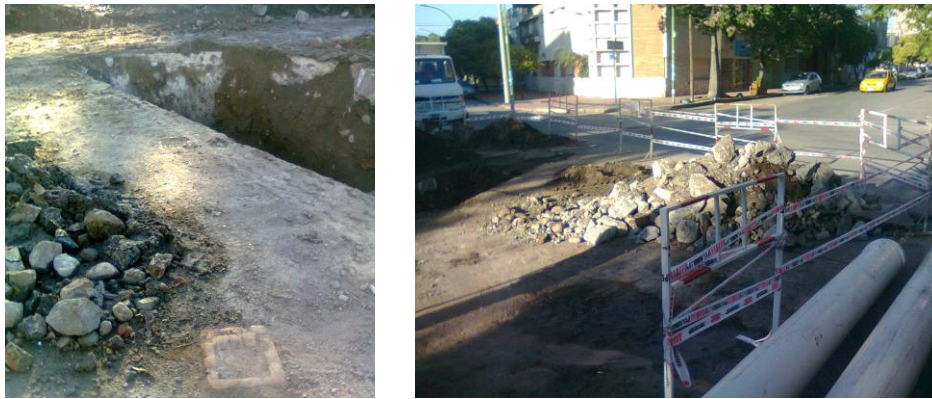
Figura 3.51: Corte diagonal del paño de H°. Escombros
