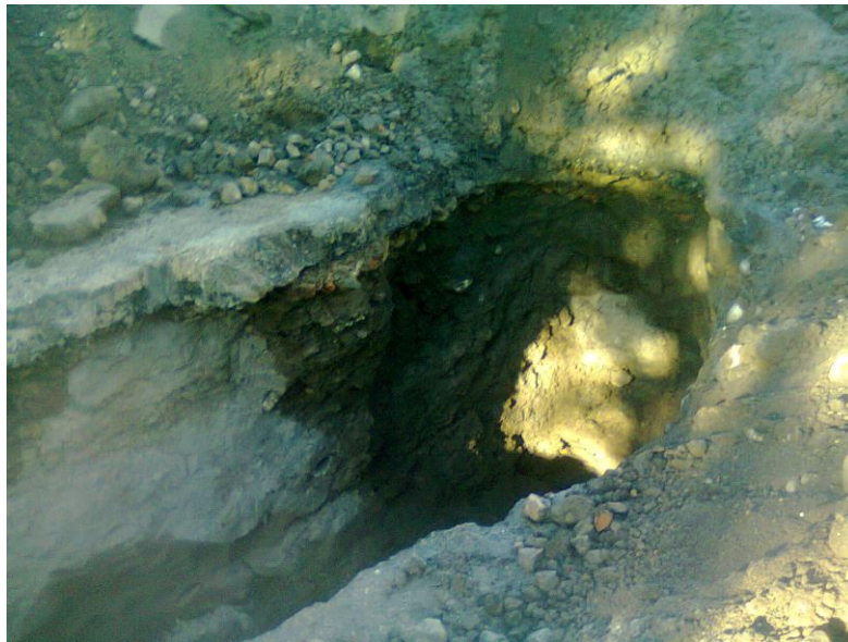
Figura 3.48: Cráter en calzada sobre la cañería existente dañada.
