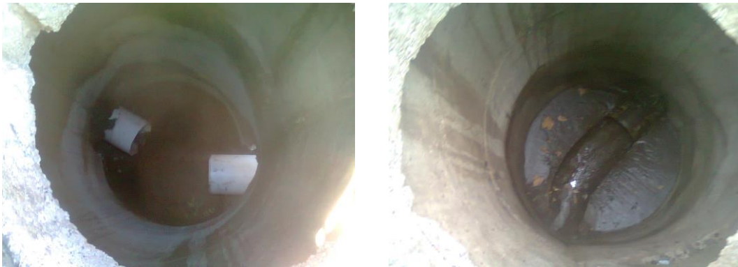
Figura 3.52: BR2: con las cañerías colocadas y a la derecha en funcionamiento.
