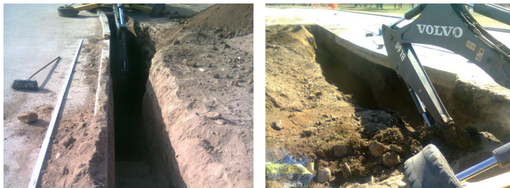
Figura 3.98: Socavamiento y deslizamiento de taludes en mantos arenosos.
