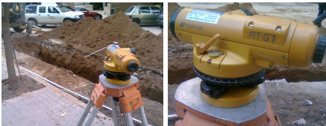
Figura 3.17: Nivel Óptico utilizado en las tareas de colocación y nivelación de cañería.
