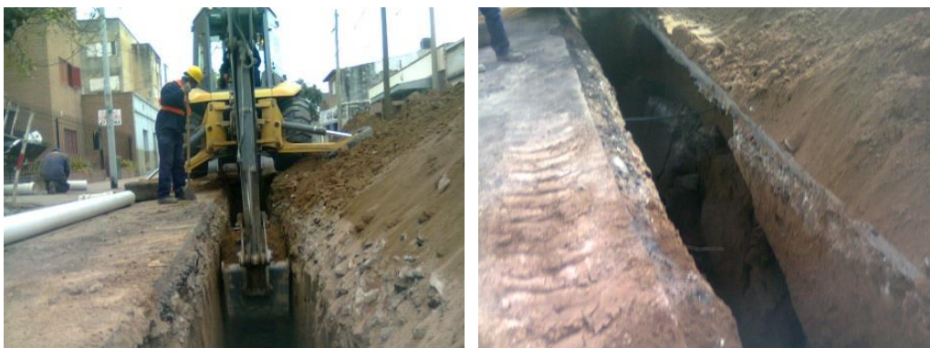
Figura 3.81: Excavación de zanja, desmoronamientos menores.
