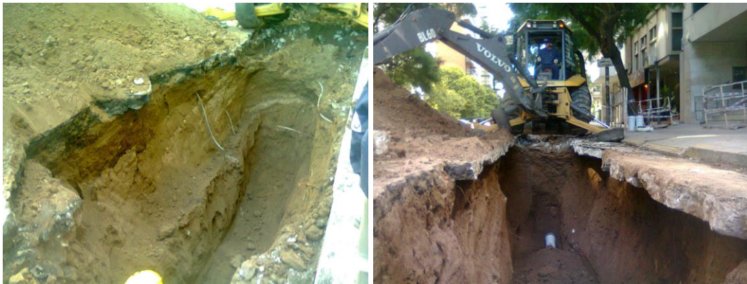
Figura 3.16: Desprendimientos de suelo y descalce de pavimento durante la excavación
