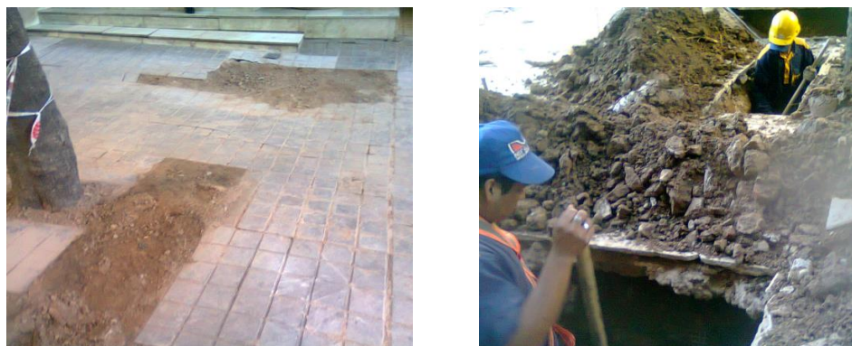
Figura 3.31: Vereda hundida y heterogeneidad en el relleno bajo el solado.
