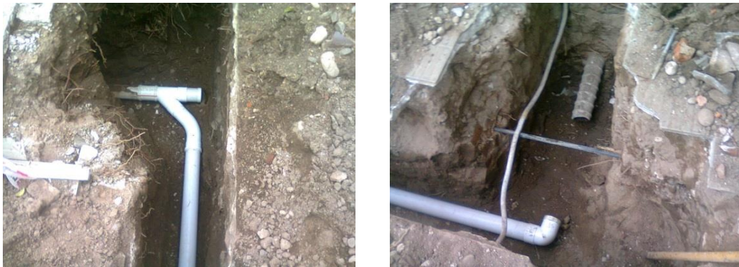
Figura 3.59: Conexión de servicio no declarado previo al inicio de la obra.
