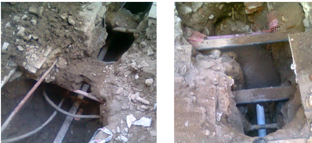
Figura 3.34: Interferencias encontradas durante la excavación de servicio.
