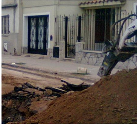
Figura 3.74: Rotura de pavimento
