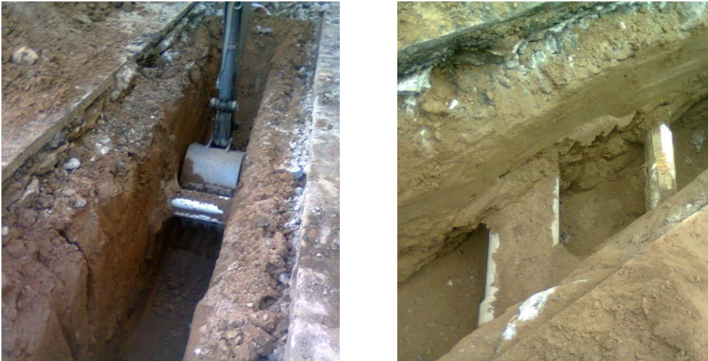
Figura 3.15: Interferencias encontradas durante la excavación mecánica.
