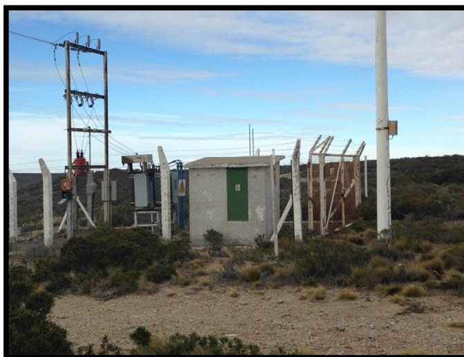
Fotografía 2.4: estación convertidora de distribución
