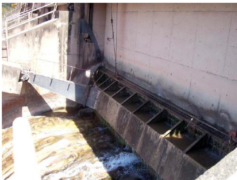
Figura 24: Compuertas circulares Dique Móvil. Evidencia de problemas de mantenimiento de las obras electromecánicas (Halcrow, 2009).
