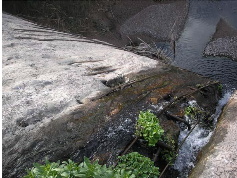
Figura 23: Deterioro en el perfil del Dique Fijo. Las armaduras están expuestas y se observa el crecimiento de vegetación (Halcrow, 2009).
