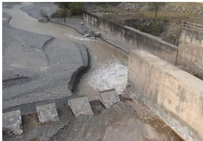
Figura 22: Erosión local al pie del canal moderador (Halcrow, 2009).
