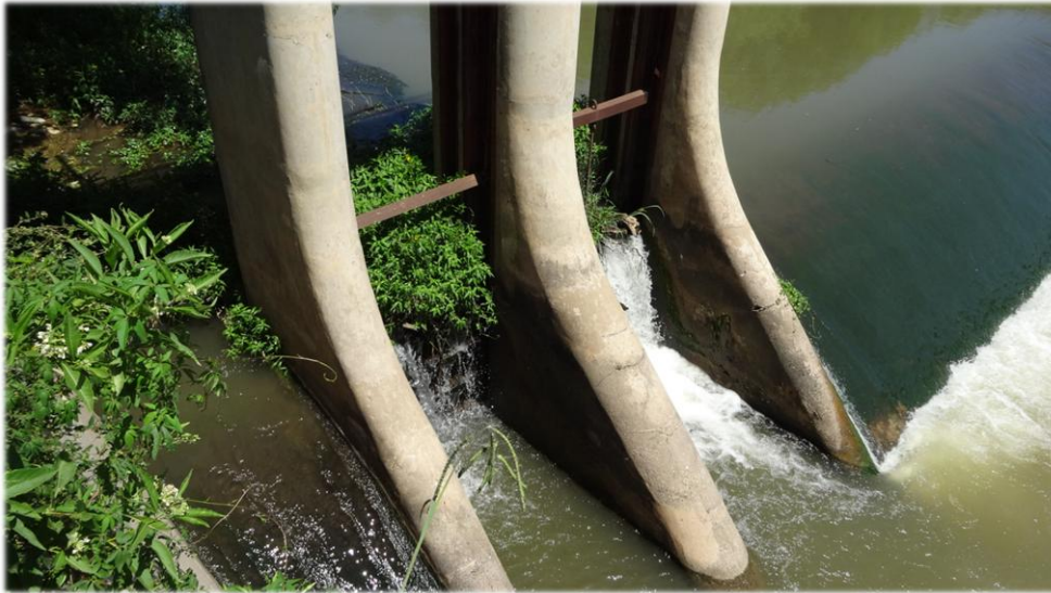
Figura 3.42 - Compuertas en azud Bell Ville.
