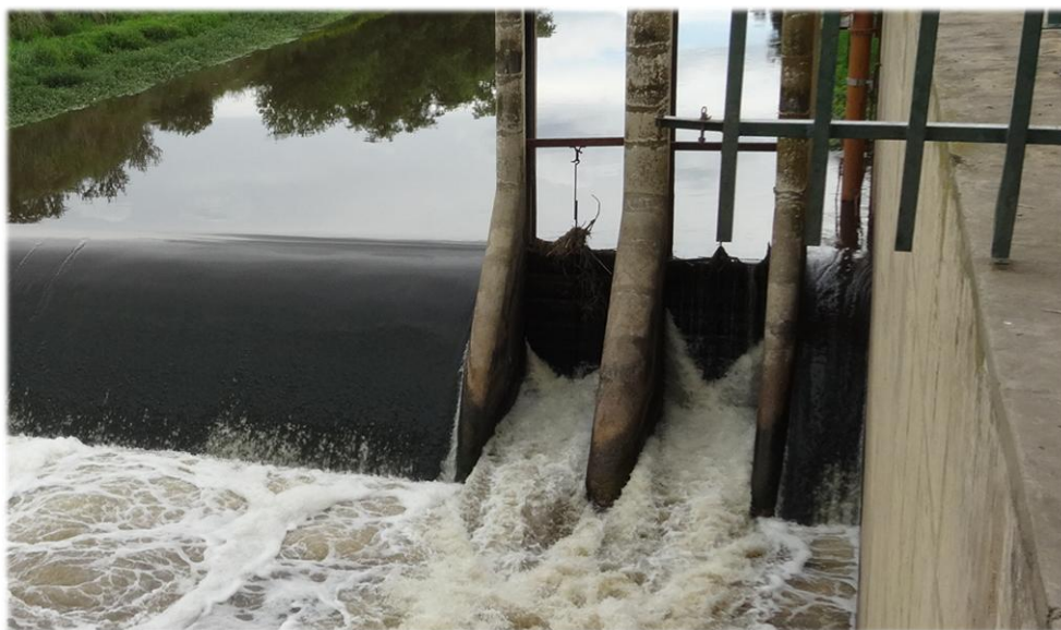
Figura 3.45 - Compuertas en azud San Marcos.
