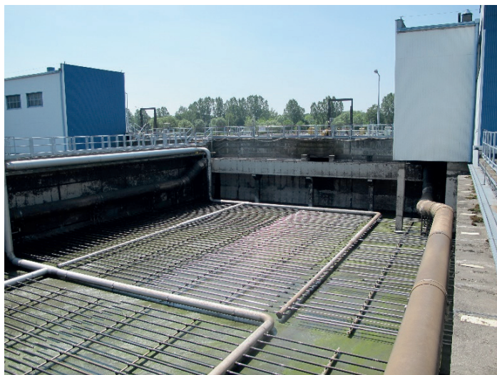
Rys. 11.4. Komora biologiczna osadu czynnego z systemem napowietrzającym
