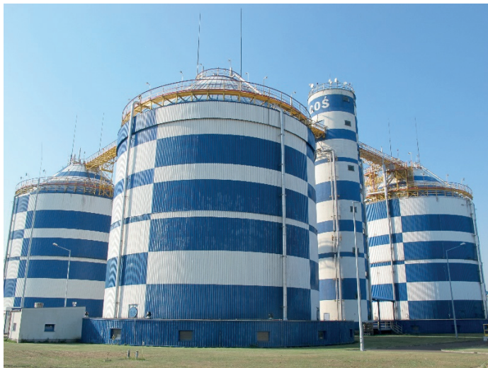
Rys. 5.1. Komory fermentacyjne osadów ściekowych
