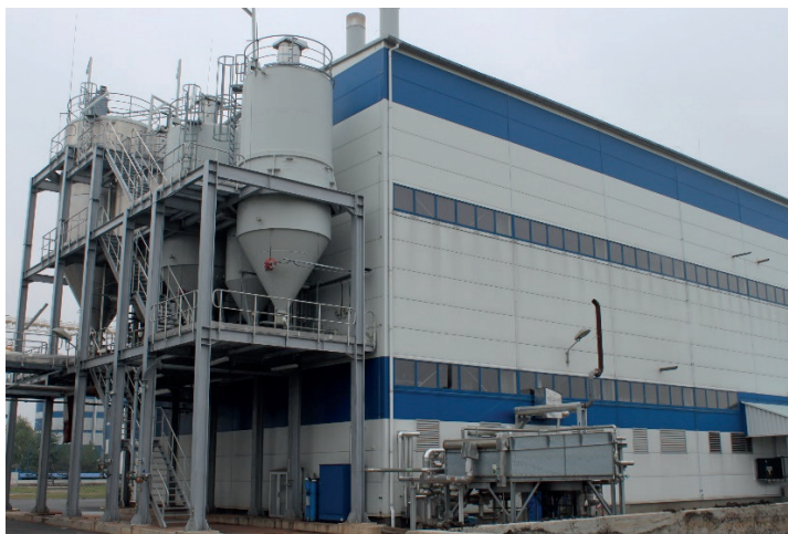
Rys. 11.10. Spalarnia osadów ściekowych
