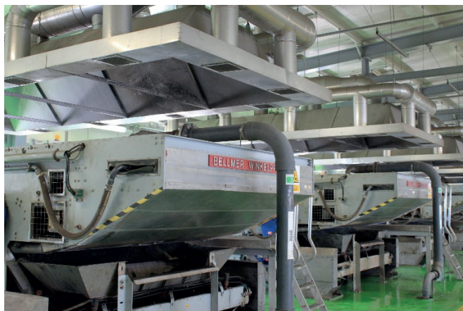
Rys. 11.9. Instalacja odwadniania osadów ściekowych
