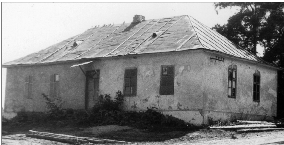
Fot. 15. Zdeprawiony budynek szkoły niemieckiej w Bekerowie, do której uczęszczały dzieci parafian obrządku łacińskiego (stan z sierpnia 1990 r.)
