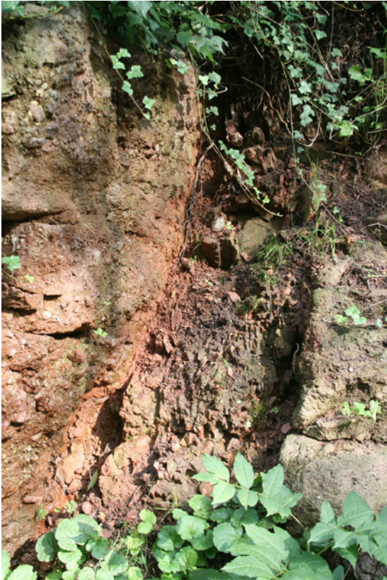
Abb. 8: Tuffspalte am Riveufer nördlich der Gaststätte Felsenpavillon. (Foto: H.-J. Altenburg)
