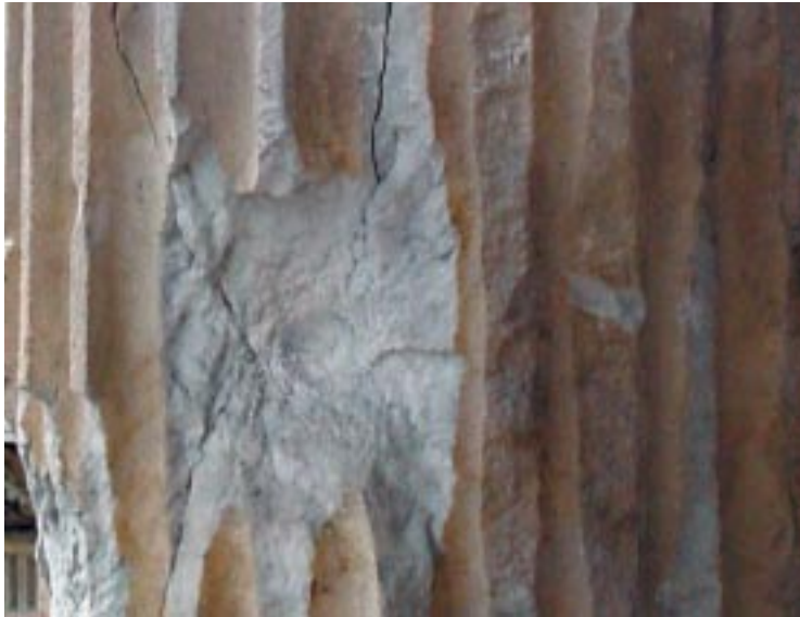
Abbildung 2: Risse in den Säulen und Abplatzungen durch Bombentreffer
