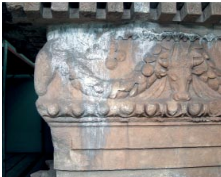
Abbildung 4: Mörtelschleier und Sinterbildungen sind ein allgegenwärtiges Problem
