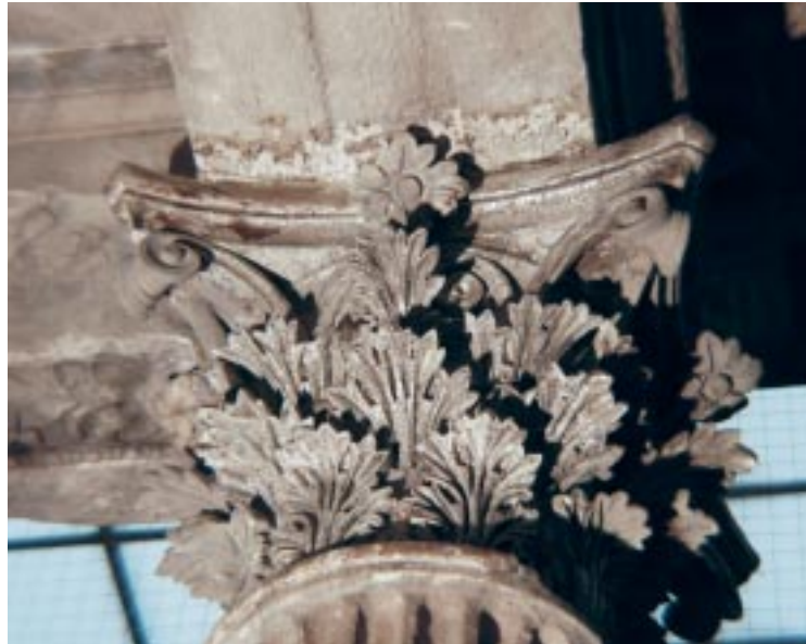
Abbildung 3: Alte Schutzanstriche im Bereich der Kapitelle führen zu deutlichen Verfärbungen
