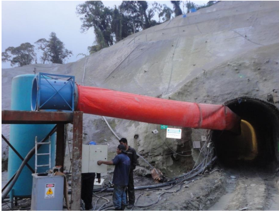
Foto 20, Ventilador de 60 hp con manga de 70mm
