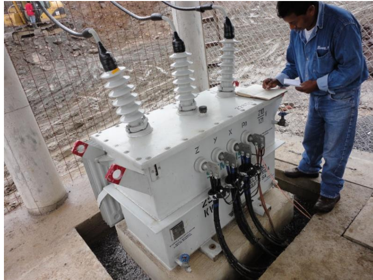
Foto 4, Planta de 250 Kw.
