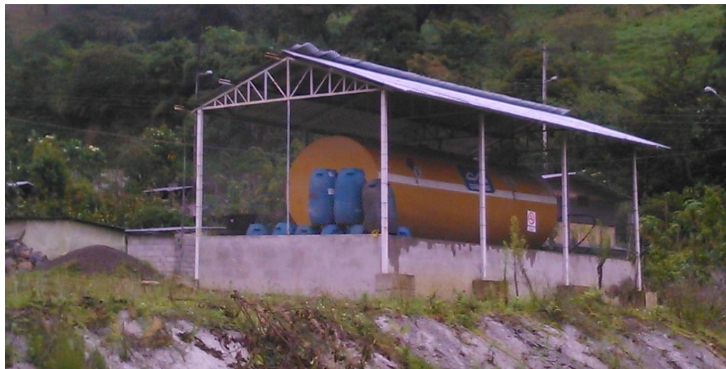
Foto 11, Cubeto 6000 Lts. y Trampa de Grasas.
