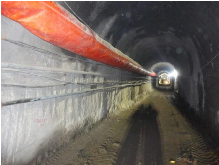
Foto 21, Manga de Ventilación 70mm dentro del túnel.
