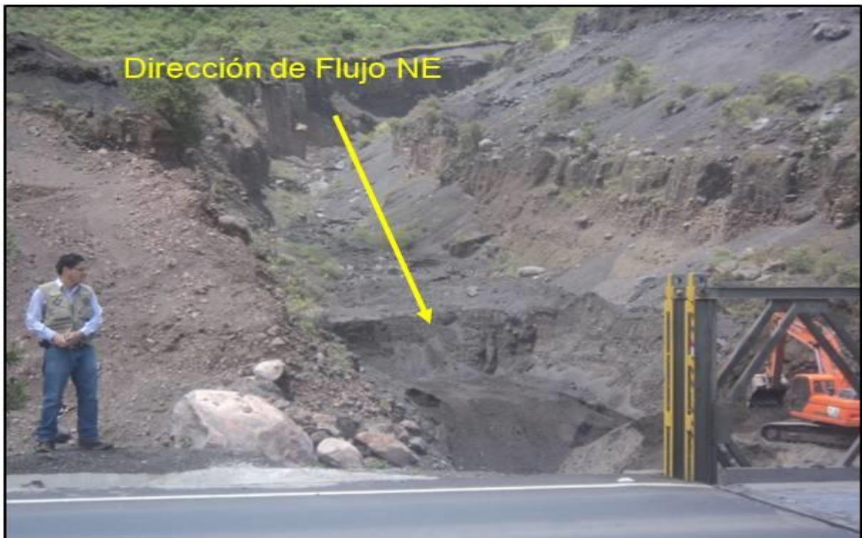
Foto N.4 Obra Construida sobre un depósito de lahar (Flujo con alta carga de sólidos).Sector "Los Pájaros".
