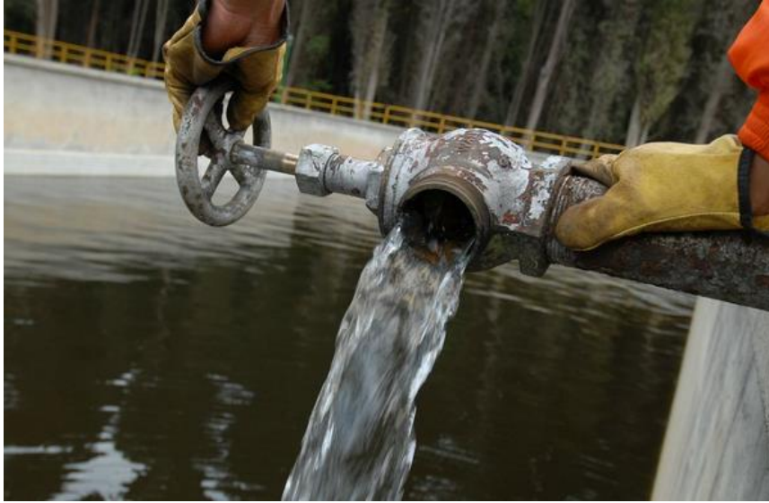
FIGURA 2.8. CONTROL DE VALVULAS DE AGUA POTABLE
