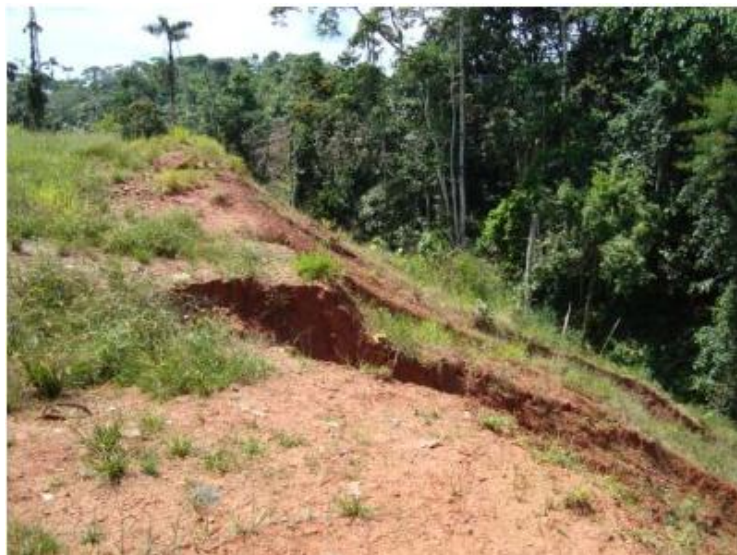
Figura 40. Erosión en taludes de material de excavación.
