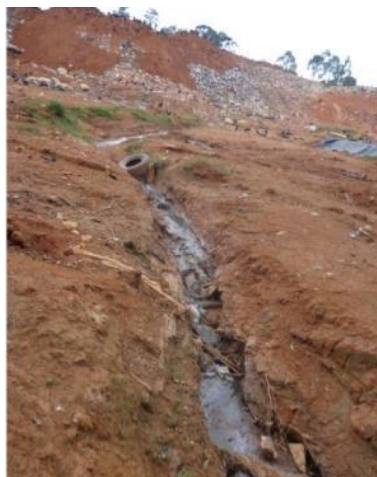
Figura 36. Contaminación con lixiviado disposición directa.
