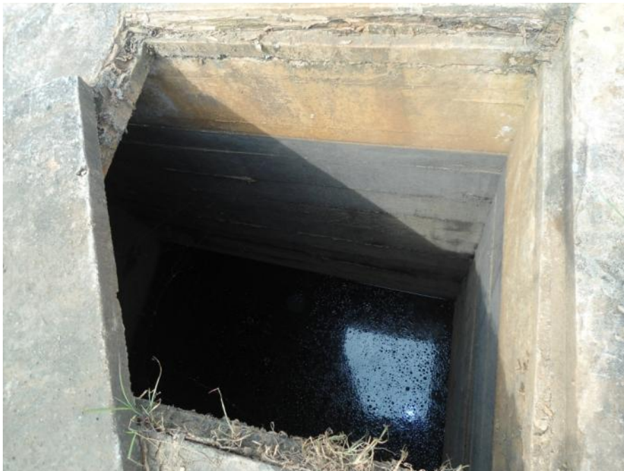
Figura 31. Cisterna para almacenamiento de Lixiviados.
