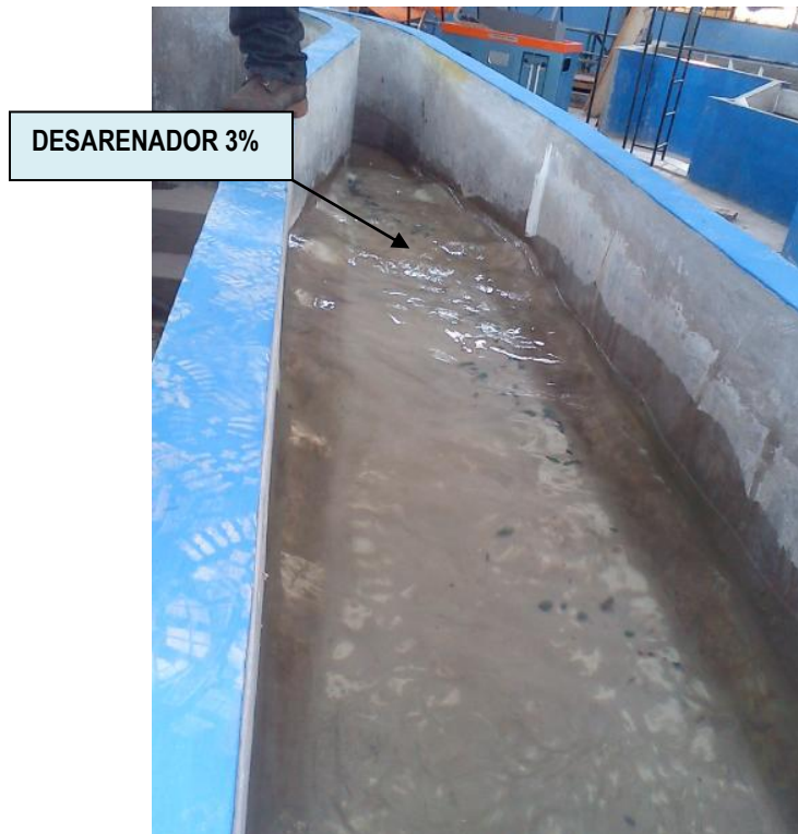
Fotografía 6.3. Flujo en el desarenador con pequeños caudales (tomado por: Herrera Diego)
