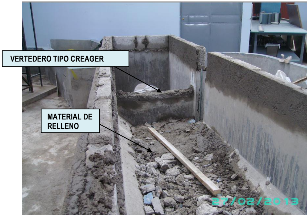
Fotografía 5.3. Material de relleno para el cambio de pendiente. (tomado por: Herrera Diego)
