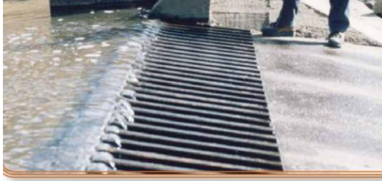
FOTOGRAFÍA 2.3. Rejilla de entrada
