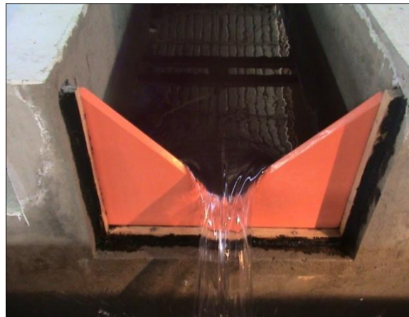
Fotografía No 4.17: Aforo del caudal por el vertedero.
