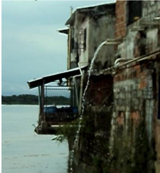
Ilustración 9. Vertimiento de aguas servidas a río Cauca
