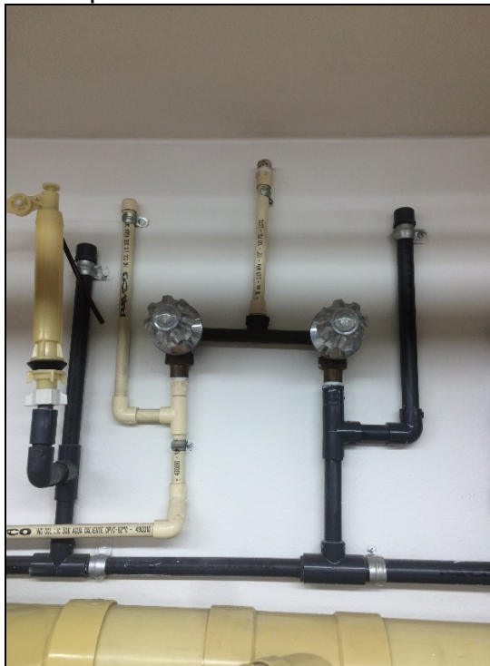
Figura 25. Instalación usada para el sistema de ducha en un hogar.
