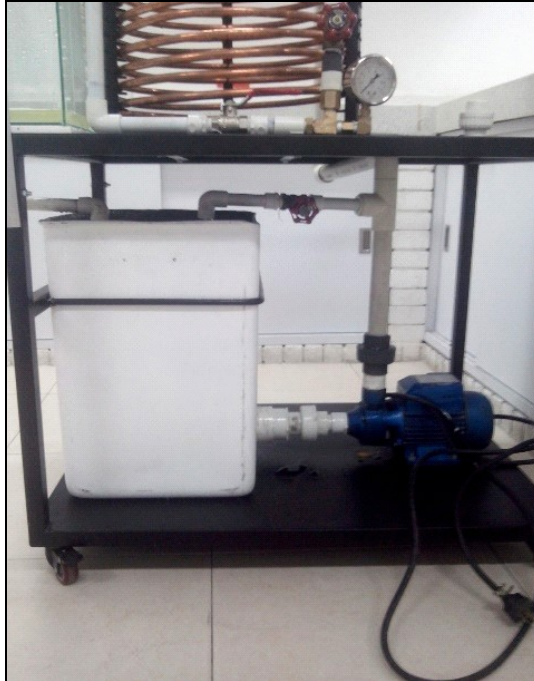
Figura 31. Manómetro 2, tanque de almacenamiento y bomba.
