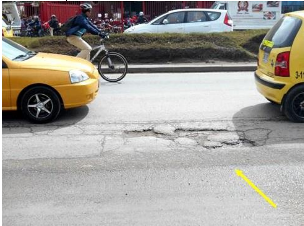
Figura 11. Déficit carpeta asfáltica.
