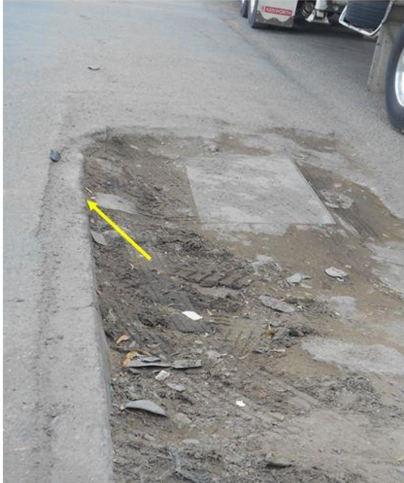
Figura 12. Déficit confinamiento de la vía.
