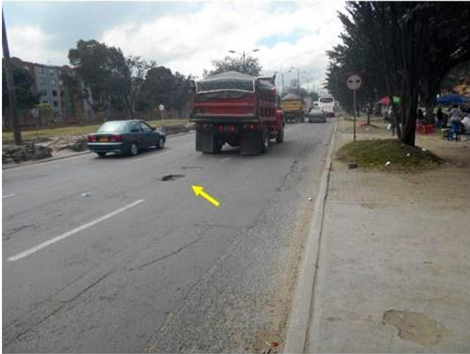
Figura 10. Déficit carpeta asfáltica.
