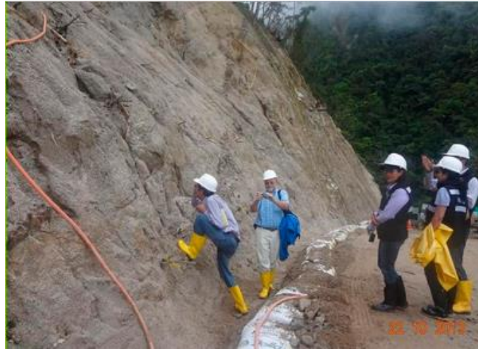
Figura 32. Frente Mocoa, sector puente Campucana. Chequeo de pendiente en talud K10+300 M.I.
