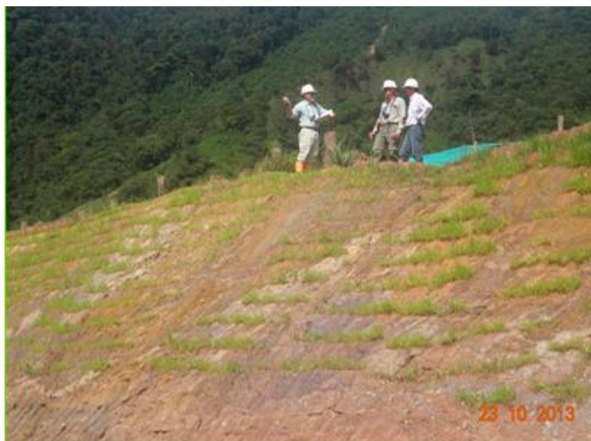
Figura 33. Frente Mocoa, sector Campucana. Inspección talud emhradizado, K8+100 M.I.
