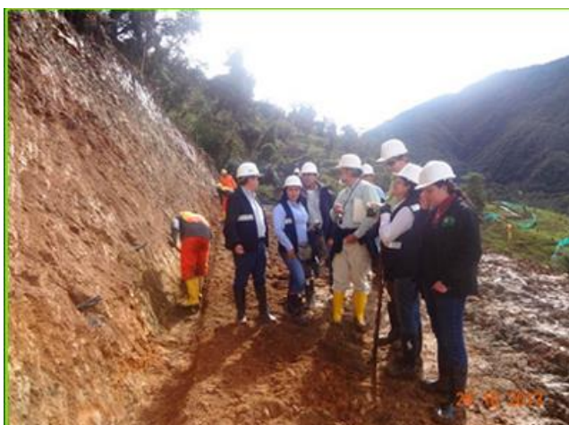
Figura 34. Frente San Francisco, sector Puente Putumayo. Inspección taludes y terrazas de la explanación sector K4+500
