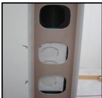
Figura 35. Instalación eléctrica dentro de muro.
