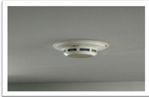
Figura 11. Sistema de detección de incendios
