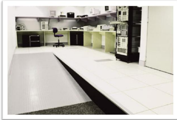
Figura 42. Rampa del área de servidores
