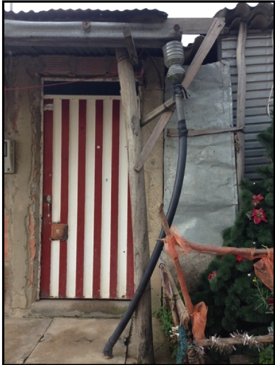
Figura 9. Drenaje artesanal de aguas lluvias.
