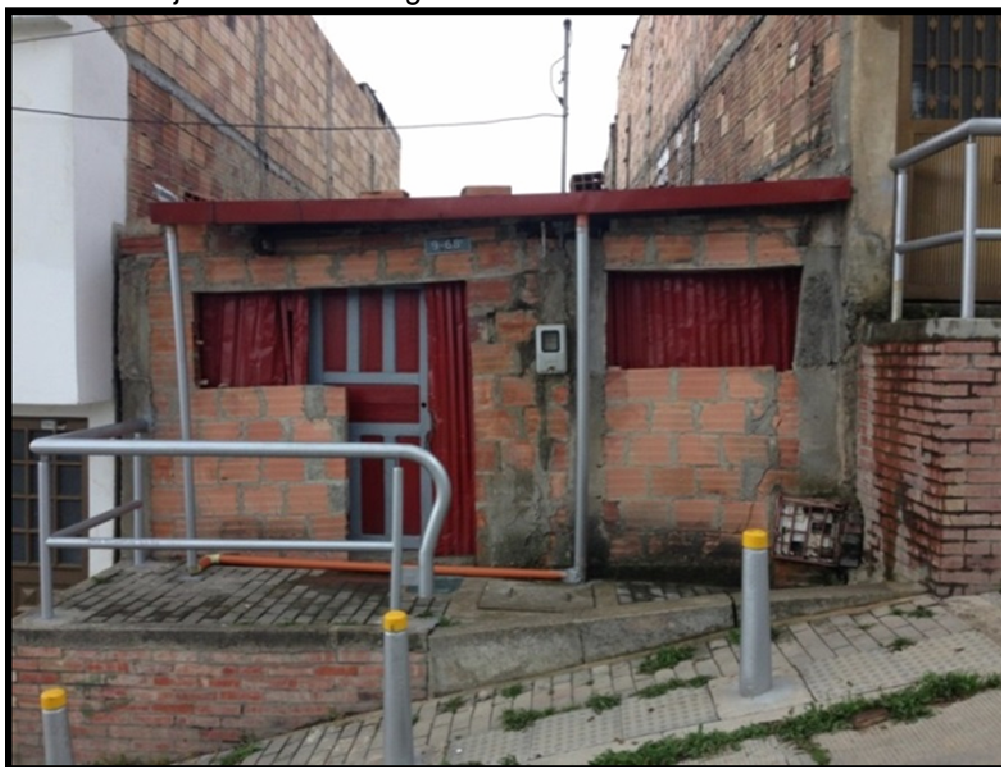
Figura 10. Drenaje artesanal de aguas lluvias.
