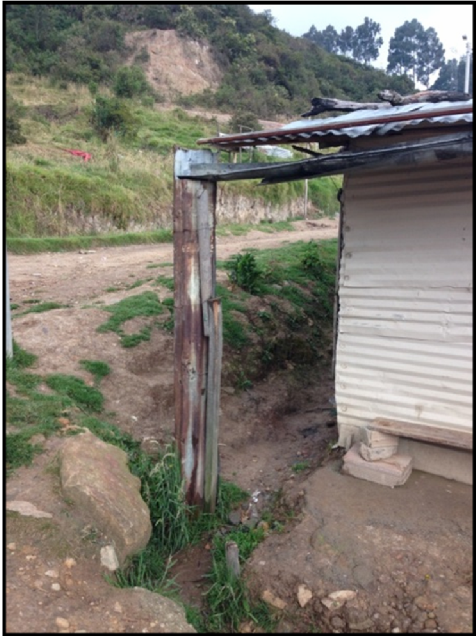
Figura 13. Sector de alto riesgo.
