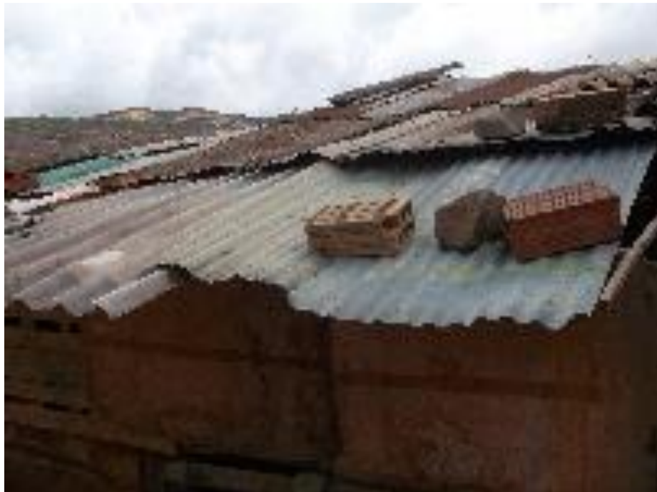
Imagen del exterior de la vivienda-Estado de la cubierta
