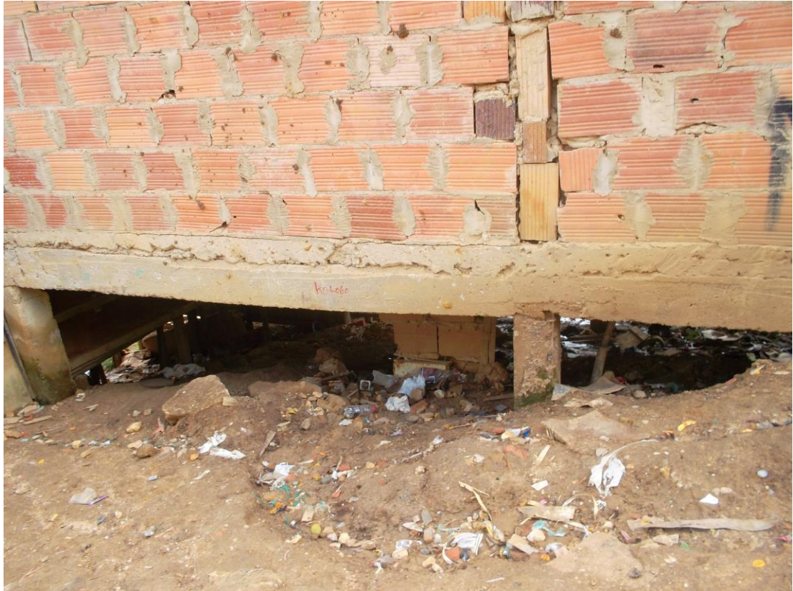
Imagen del exterior de la vivienda-Estado de la cimentación
