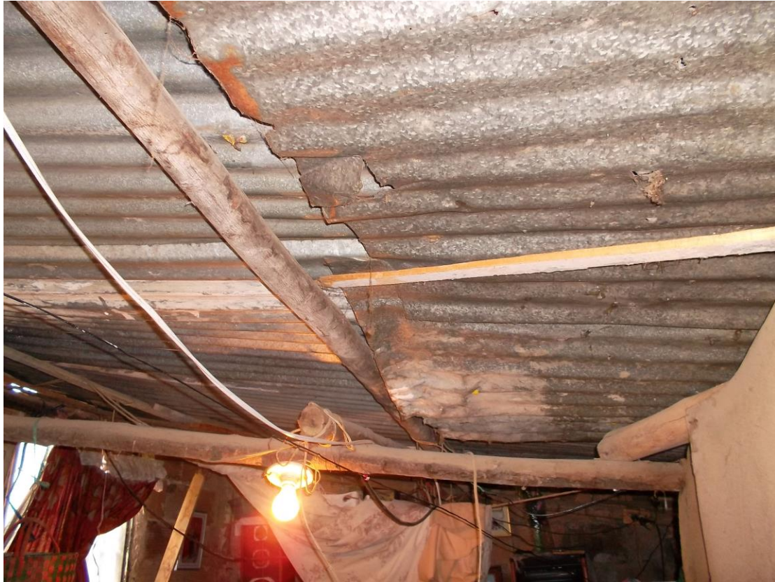
Imagen del interior de la vivienda-Estado de la cubiert
