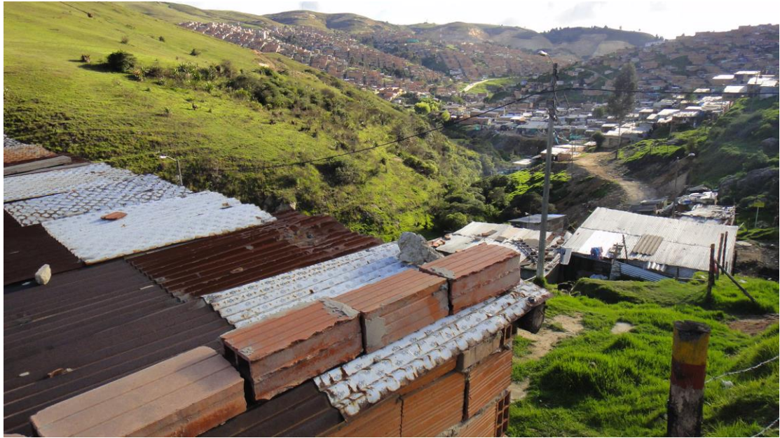
Ciudad Bolívar-Barrio caracolí- Estado de las cubiertas
