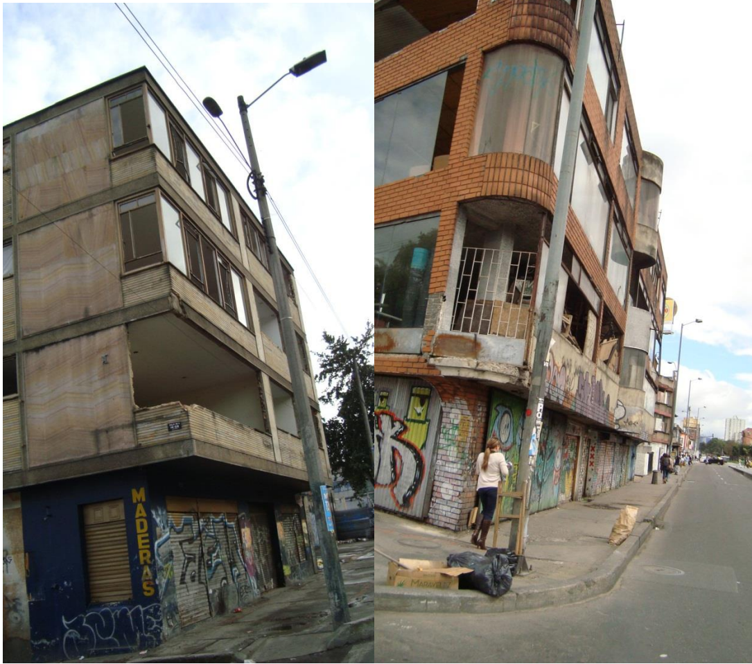
Detalle deterioro físico espacial avenida Troncal Caracas
