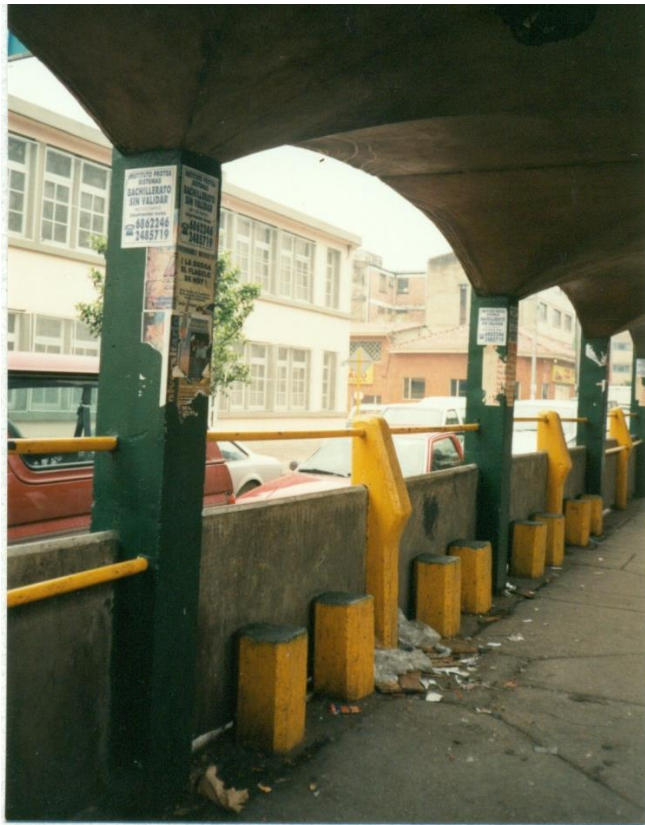
Detalle paradero de buses, desgaste y desapropiación de los ciudadanos.
