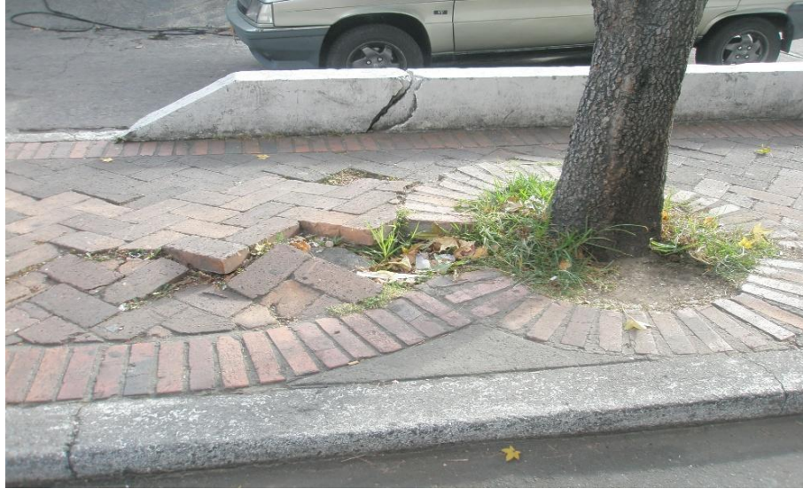
Figura 2. Afectación a andén, Avenida Carrera 7 No. 69a-22, Bogotá. Fotografía: Javier Fernández.
