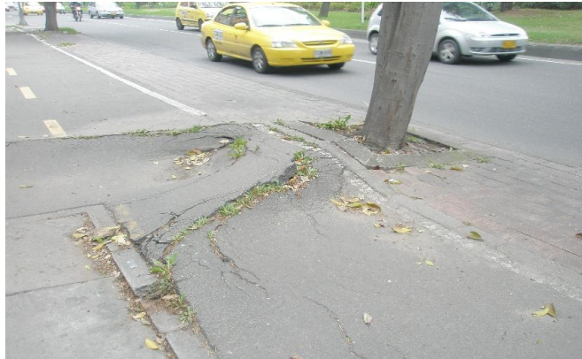
Figura 1. Afectaciones en la infraestructura vial, a causa de los árboles. Fotografía: Javier Fernández.
