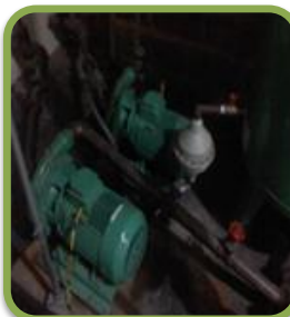
Gráfica 13. Equipos de bombeo de agua
