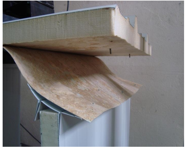
Figura 61. Falla típica sistema remache pop con tornillo con capelote
