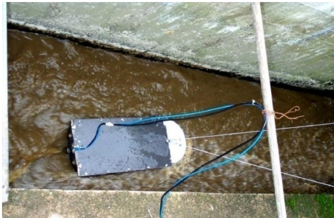
Figura 2.4. Vista frontal de la instalación del equipo de medición con forma de bote flotante (Lorenz et al. , 2002).
