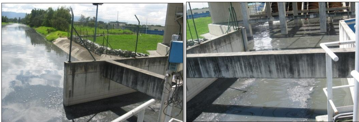
Figura 3.29 Bocatoma efluente Planta de tratamiento de aguas residuales El Salitre (Autor, 2011).
