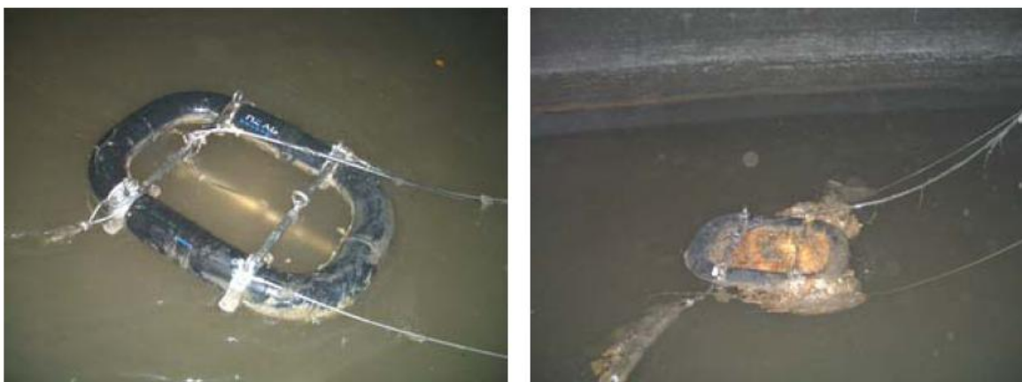
Figura 2.7 Instalación espectrómetro UV-Vis en alcantarillado de Linz, Austria (Hochedlinger et al. , 2006).
