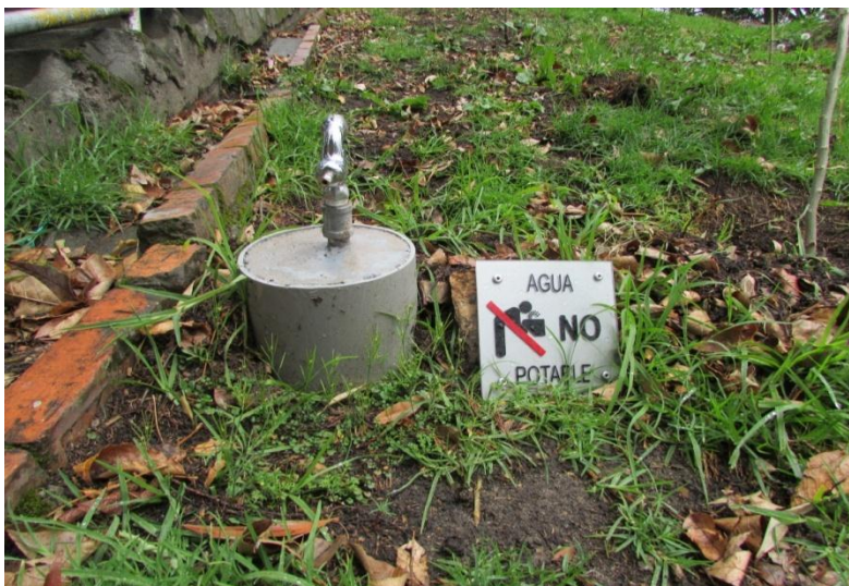
Ilustración 15. Salida de agua proveniente del tanque de almacenamiento
