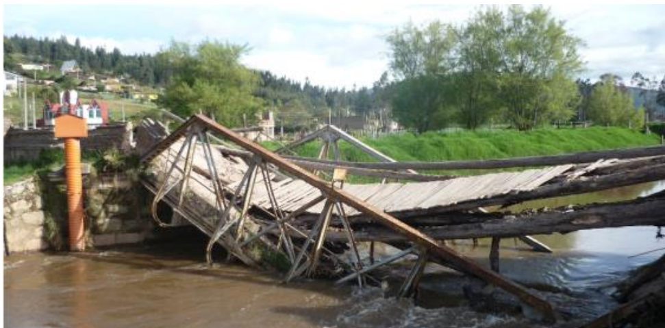
Foto 2-5 Colapso de puente en Tibasosa por ola invernal Fuente: (Alcaldía de Tibasosa, 2012)
