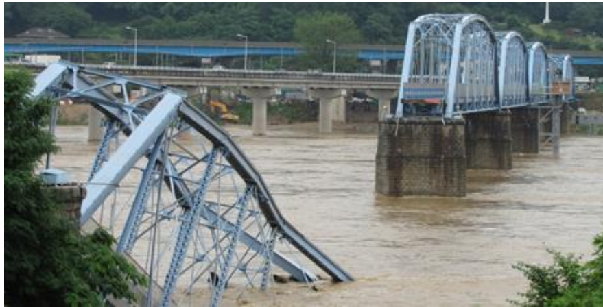
Foto 2-1 Colapso de puente del ferrocarril Waegwan - Bridge over river Seoul- Corea del Sur Fuente: (UCA News, 2006)
