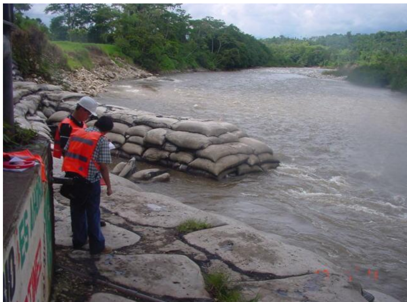
Foto 5-24 Obras de protección hidráulica en la subestructura del puente Fuente: (Muñoz E. , 2012)
