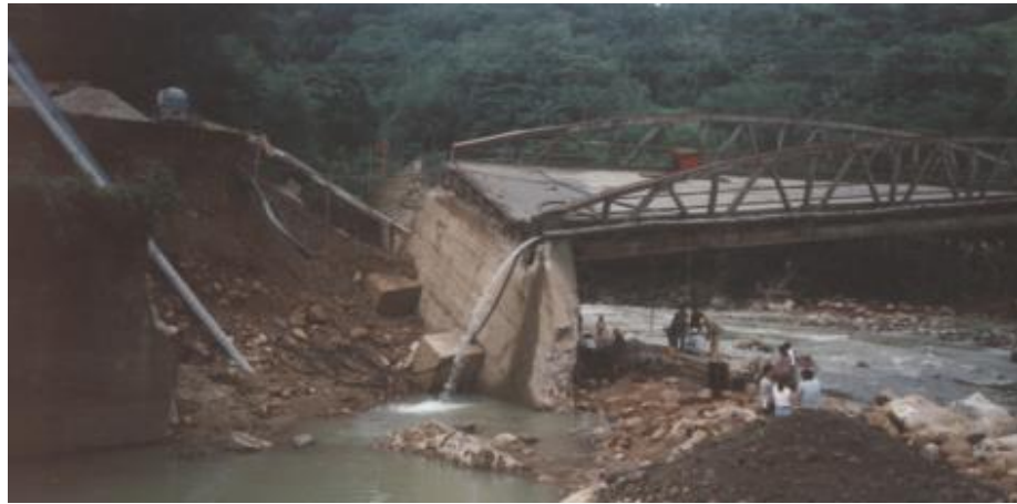
Foto 2-3 Colapso del Puente Únete (Casanare) Fuente: (Muñoz E. , 2012)
