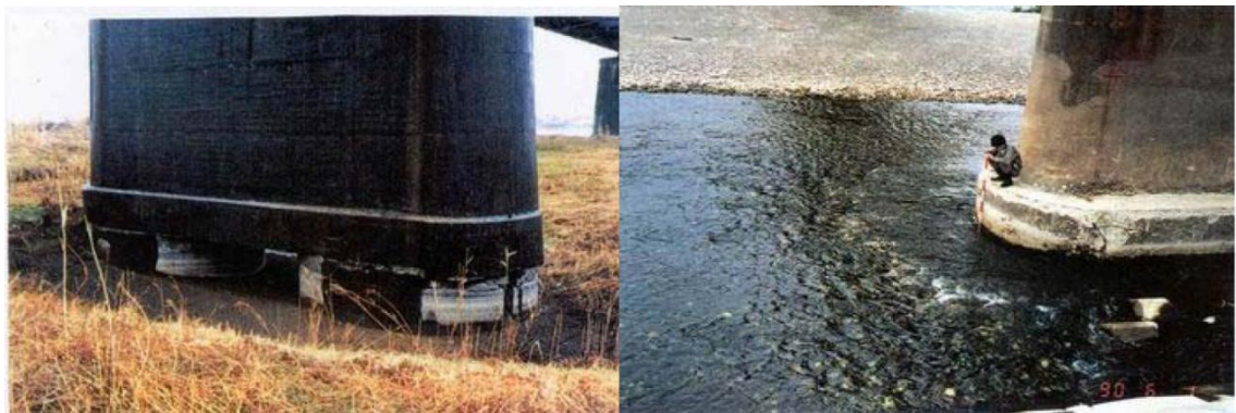
Foto 4-1 Socavación en lecho móvil y Socavación en agua clara Fuente: (Guevara, 1998)
