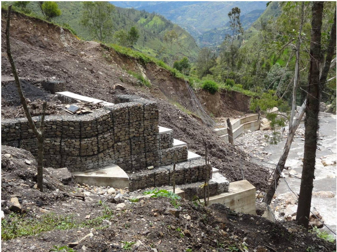
Foto 6-1 Erosión en ladera del puente Los Gaviones
