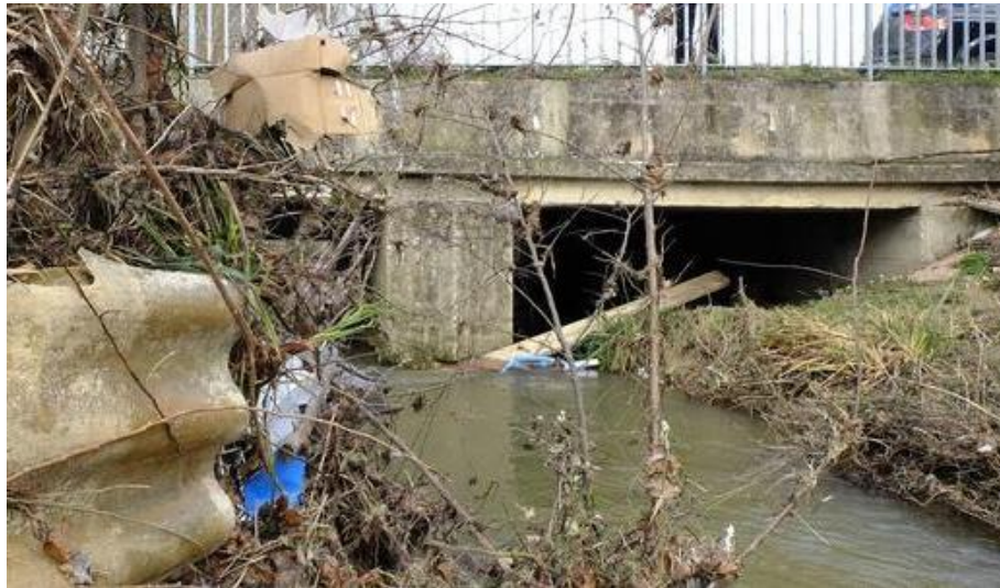
Foto 5-23 acumulación de residuos en aletas, pilas y/o estribos Fuente: (Noticias Álava, 2013)
