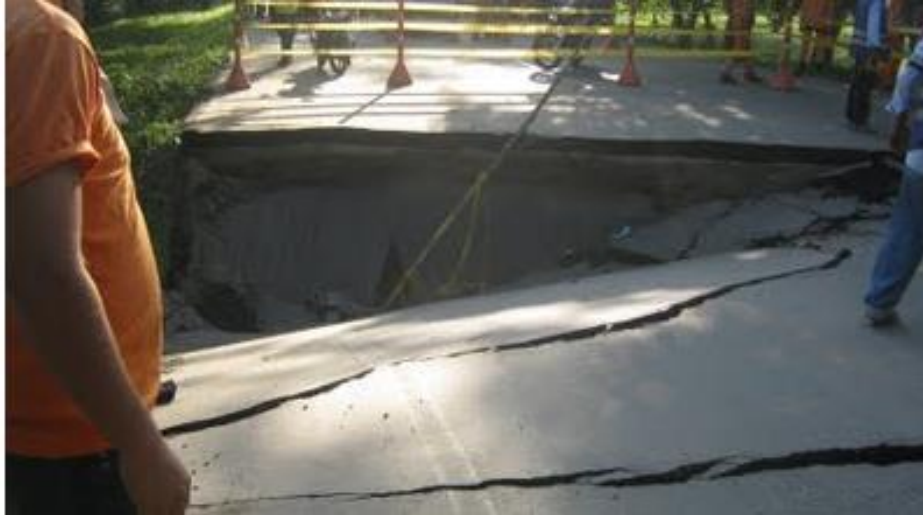
Foto 2-4 Colapso de un puente en el municipio de Ariguani por ola invernal Fuente: (Diario Ariguani al día, 2013)
