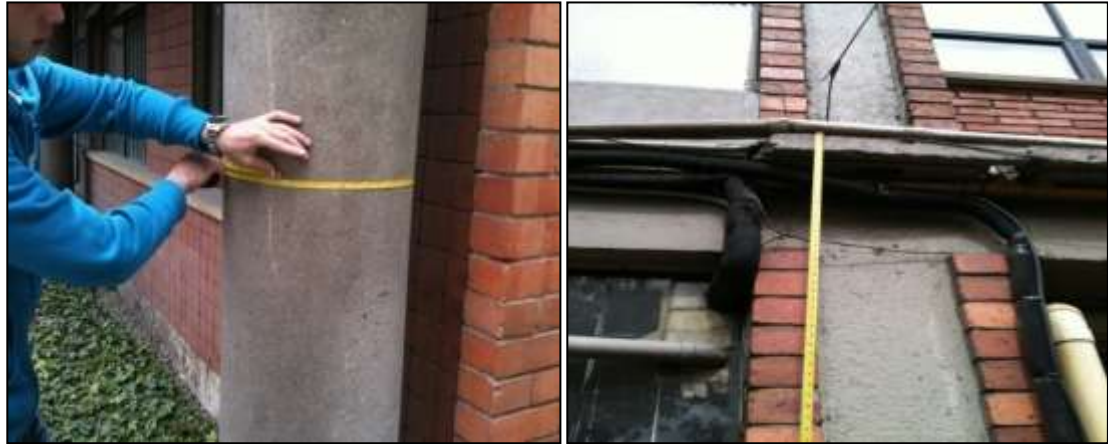
Figura 4. 5– Verificación de las dimensiones de algunos elementos estructurales. (Izquierda: Columna perimetral Edificio 52; Derecha: Torta superior entrepiso Edificio 50)
