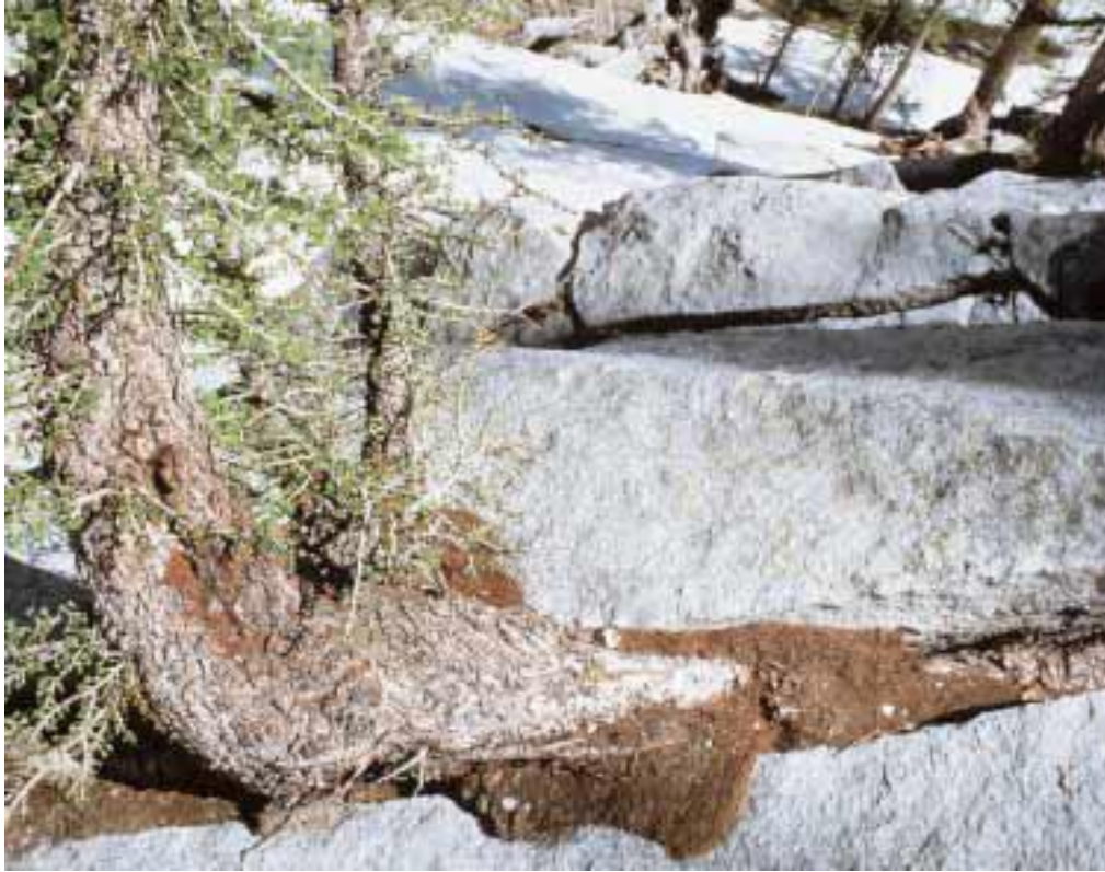
Gráfica 2.12 Grietas debidas al crecimiento de raíces (Thompson & Turk, 1997)
