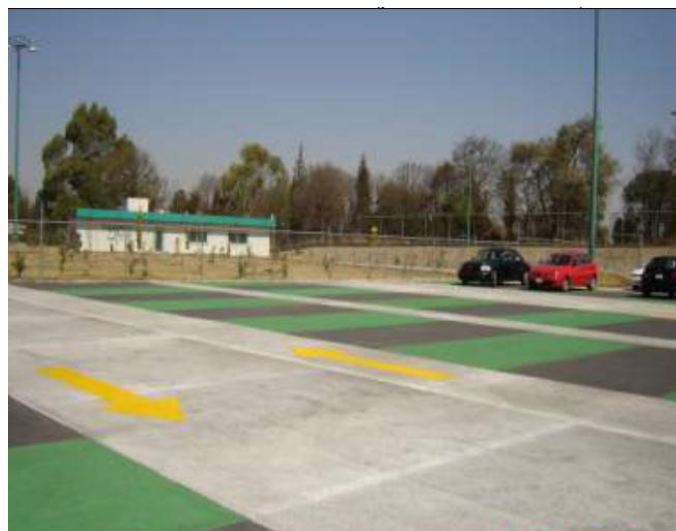
Imagen 32. Pavimento permeable en asfalto poroso en el estacionamiento de la planta de Schnyder Electric en Tlaxcala, México (Fuente: Concreto Permeable: http://www.concretopermeable.com/fichatecnicahidrocreto.pdf )
