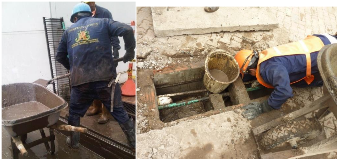
Figura 5. Mantenimiento del drenaje francés y del tanque de grasas(Promotora Apotema & Coordinación LEED 2011)
