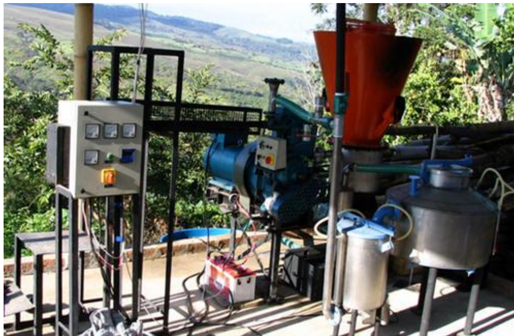
Figura 17: Sistema de Gasificación FGB 20 de la finca TOSOLY, Santander Colombia. Fuente: Ankur Scientific Energy Technologies LTD.
