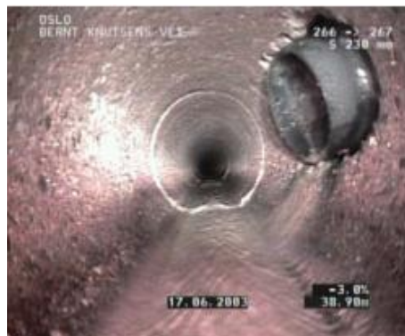
Figura 2.6: Conexiones cruzadas con pluviales (Bäckman et al. , 2005).
