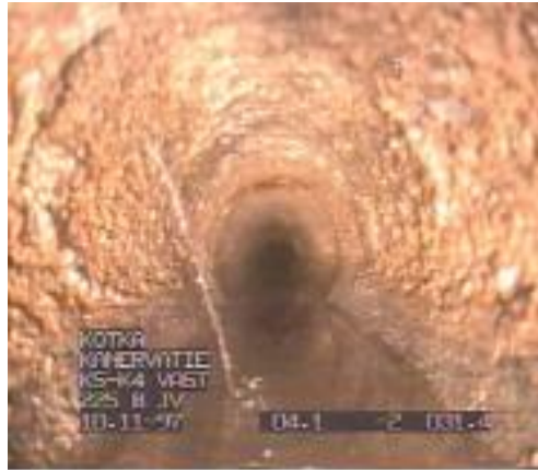
Figura 2.9: Corrosión (Bäckman et al. , 2005)
