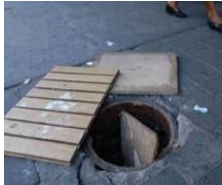
Figura 2.5: Vandalismo (Fundición Industrial Potosina, 2010).
