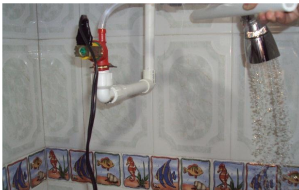
Imagen 7, Instalación de montaje final de electroválvula en funcionamiento
