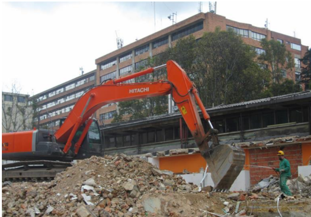
Figura 10. Demolición del edificio José Celestino Andrade llevada a cabo por ABECOL, Foto tomada de http://www.demolicionesabecol.com/proyectos/
