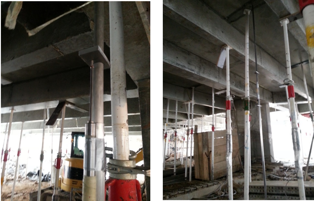
Ilustración 12.2: Equipos ubicados en la losa de estudio
