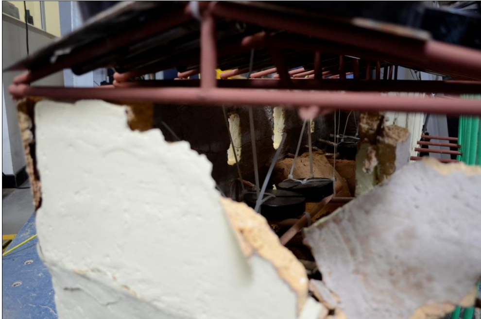
Figura 66 - Colapso de la escalera en el segundo piso
