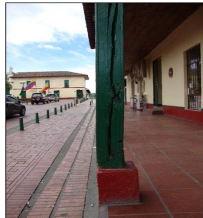
Figura 8 - Agrietamiento de la madera (Uribe et al., 2013)
