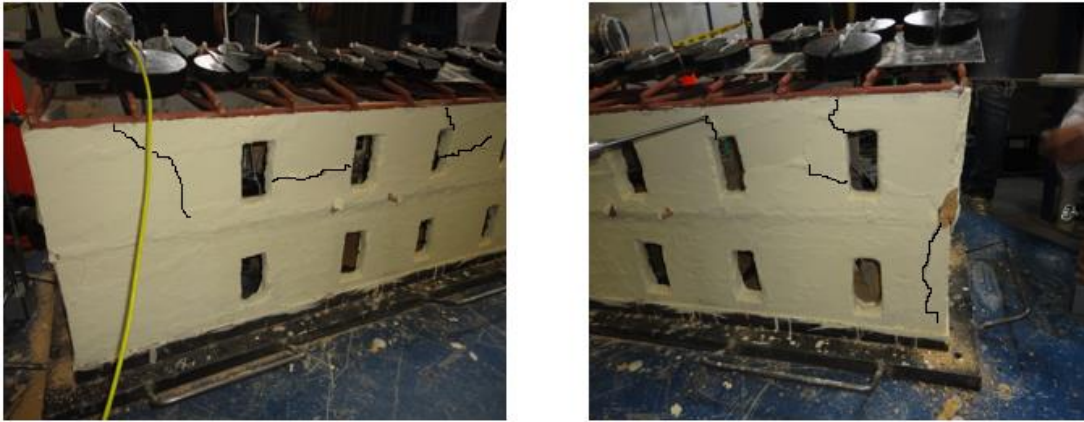
Figura 64 - Agrietamientos producidos en zona posterior por el evento sísmico
