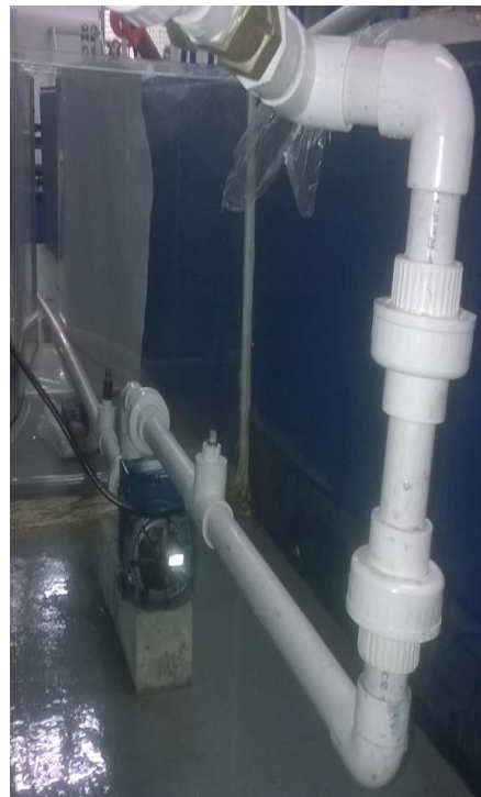
Ilustración 9.b Montaje Hidráulico: Conexión Inversa
