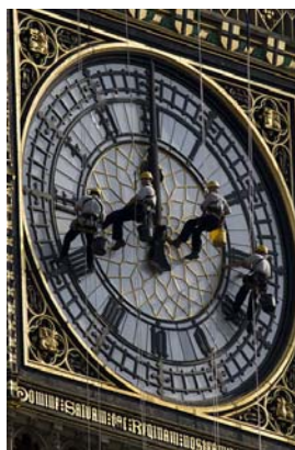
Figura 16. Trabajadores limpiando una de las caras del reloj, torre Isabel, Londres Inglaterra.
