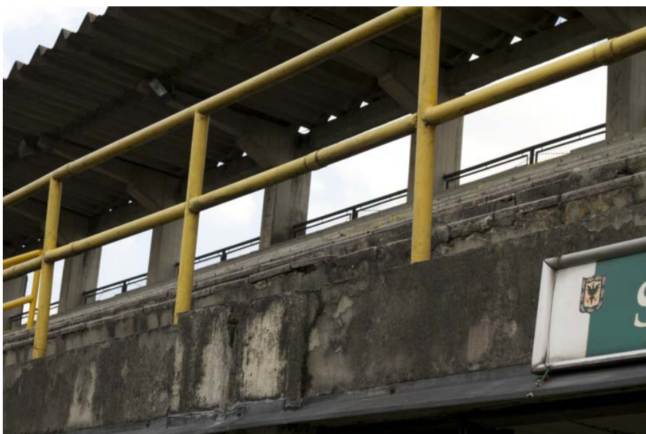
Figura N° 22. Fotografía que muestra el estado de deterioro de las graderías del estadio de atletismo de la Unidad Deportiva El Salitre. Tomada por Juan Pablo Gaitán el 10 de noviembre 2012.
