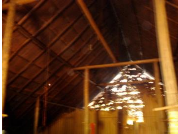
Interior de la maloka de la comunidad de Mutanacua (vista de la viga en la que se colgaron los micrófonos)
