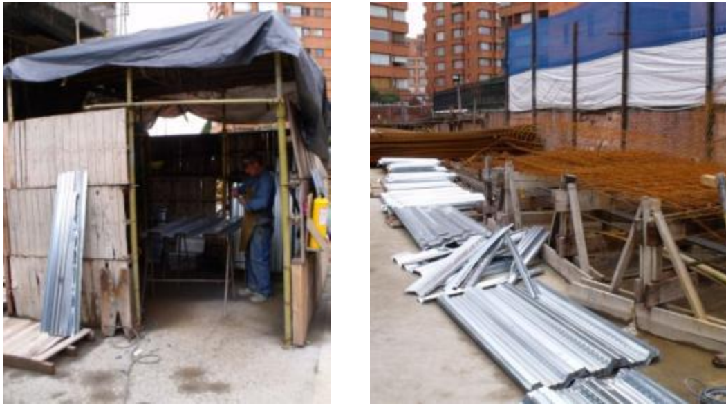
Figura 52 y 53. Caseta y zona de disposición de láminas de metaldeck cortadas. Fecha de toma: 05-NOV-11
