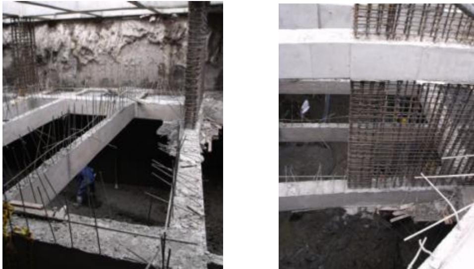
Figura 50 y 51. Viga reforzada para la construcción de las columnas posteriores. Fecha de toma: 19-NOV-11
