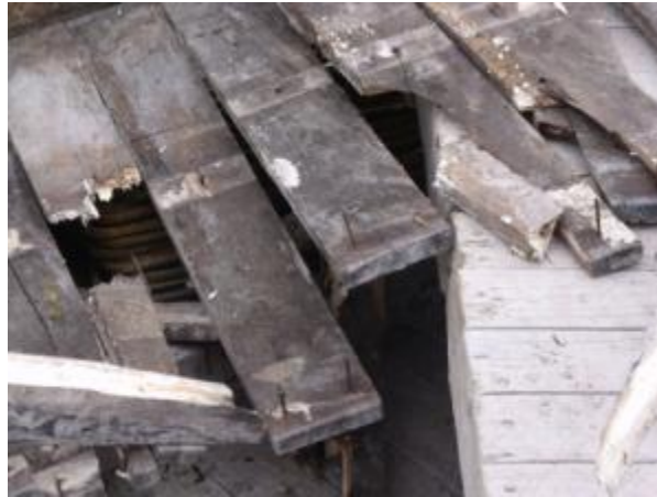
Figura 47. Camillas en mal estado. Fecha de toma: 05-NOV-11
