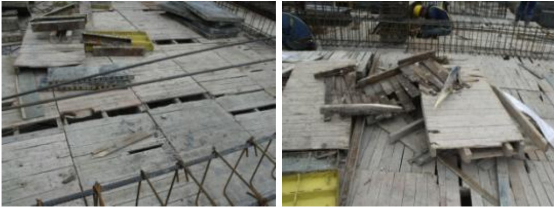
Figura 44 y 45. Estado de las camillas en madera. Fecha de toma: 05-NOV-11
